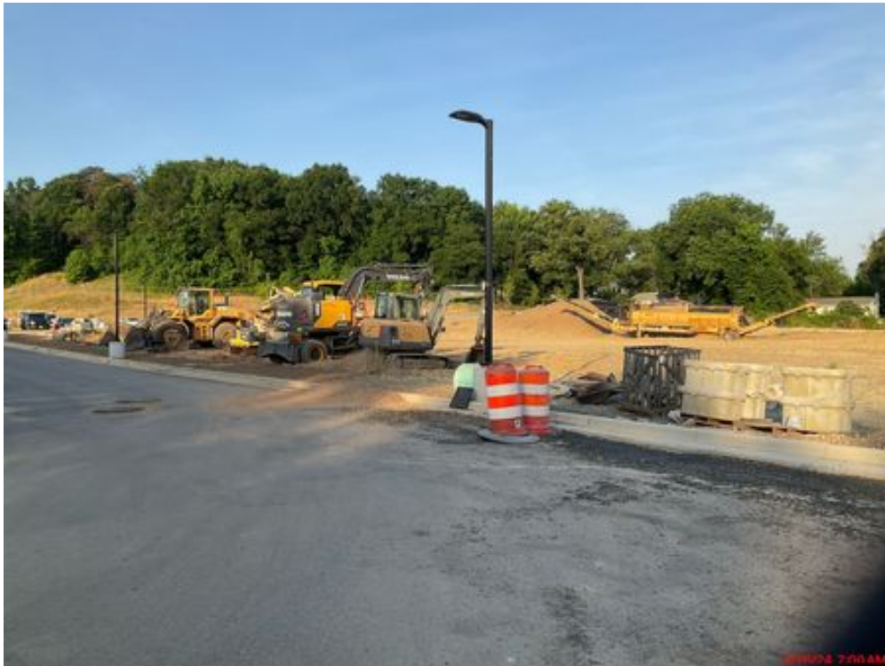
Preparación del sitio para la instalación del muro de contención y el campo de béisbol.
